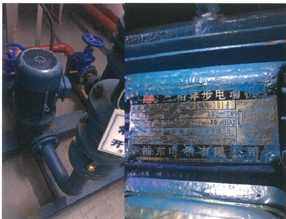
4、湿式报警阀(ZSFZ)：共 5 组报警阀，三组管低区喷淋，两组管高区喷淋。
