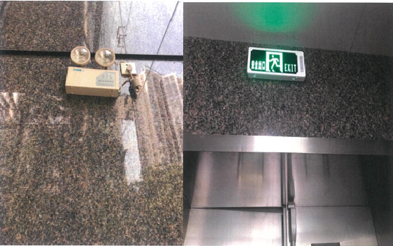
应急灯、疏散指示牌位置
