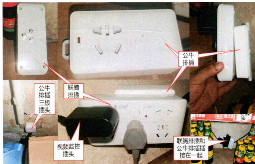
图十九 电冰柜电源转接排插现场勘查图
