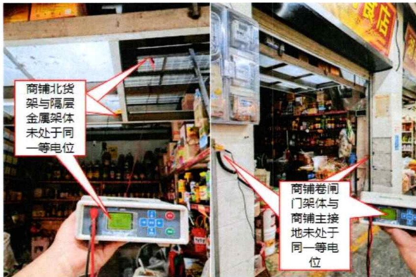
图三十一 商铺北货架与隔层金属架体等电测试图 拍摄单位：公明街道办事处 拍摄时间：2023年7月29日
